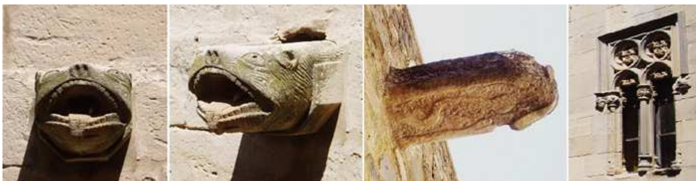
❶ Boca de una de las Gárgolas. ❷ La misma de este animal monstruoso. ❸ Otra con una serpiente tallada. ❹ Y la otra ventana de esta parte del palacio.
