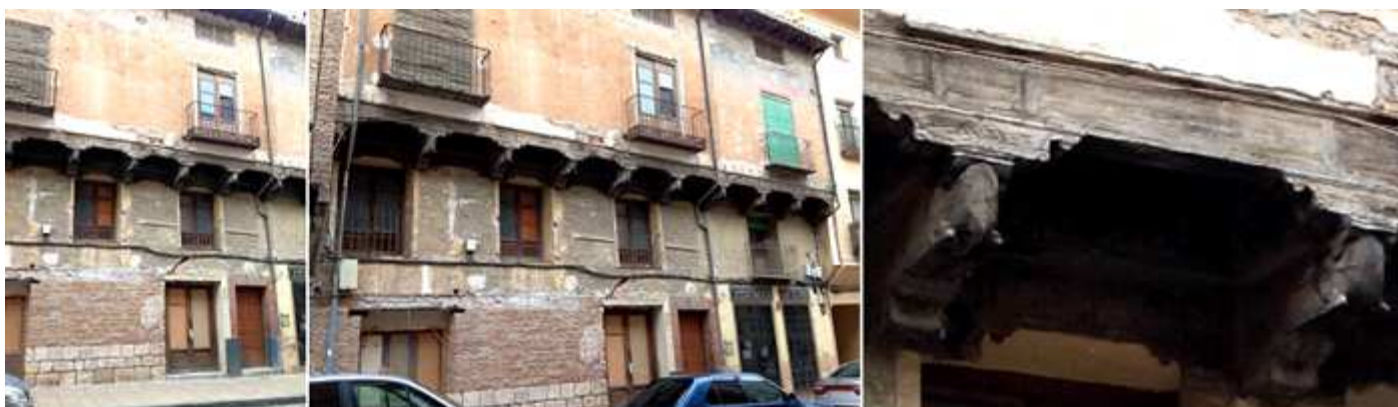
❶ Su fachada a la calle mayor, fruto actual de las sucesivas transformaciones que ha experimentado este palacio, que cuenta con tres plantas y una galería bajo su falsa. ❷ Tiene una planta en forma de U que se construyó mayoritariamente en ladrillo. Hoy día son dos viviendas particulares, con un patio central, este patio es del S. XVI. ❸ Voladizo con apeos tallados de madera.
