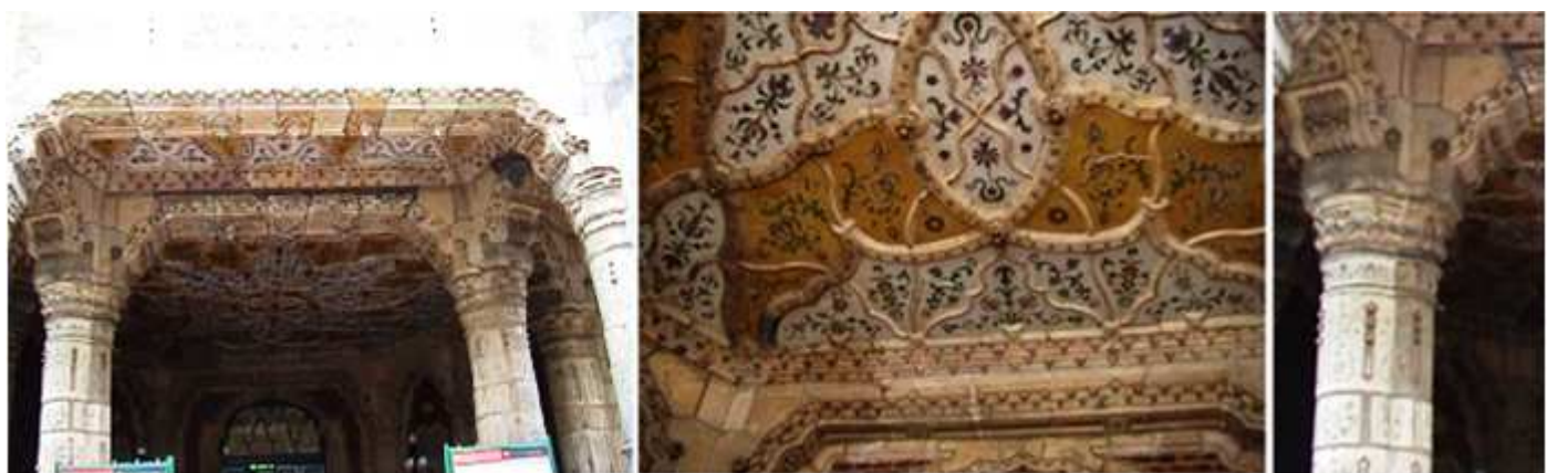
❶ Pórtico de entrada. ❷ Cubierto con esta cerámica. ❸ Con sus columnas forma un espacio octogonal.
