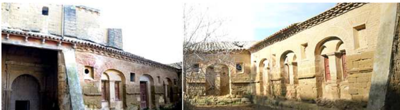
❶ Es un claustro renacentista, lateral adosado junto a la iglesia ❷ Detalle de las arcadas del claustro, cegadas. Fotos: Gobierno de Aragón (SIPCA – www.sipca.es ).
