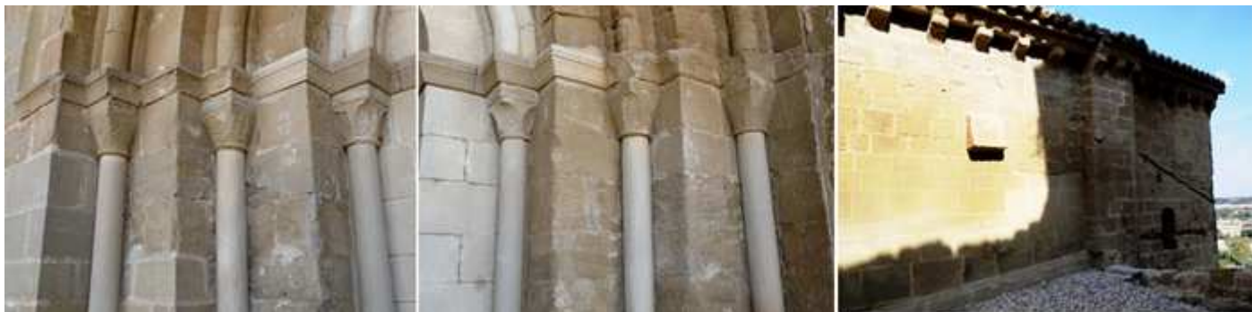
❶ Capiteles del lado izquierdo con hojas, lazos entrelazados, y hojas cóncavas. ❷ Los del lado derecho son todos de diferentes hojas vegetales. ❸ Lado exterior de la Epístola hacia la cabecera con su alero con canecillos lisos. En este lado sus muros muestran numerosos signos lapidarios de los canteros.
