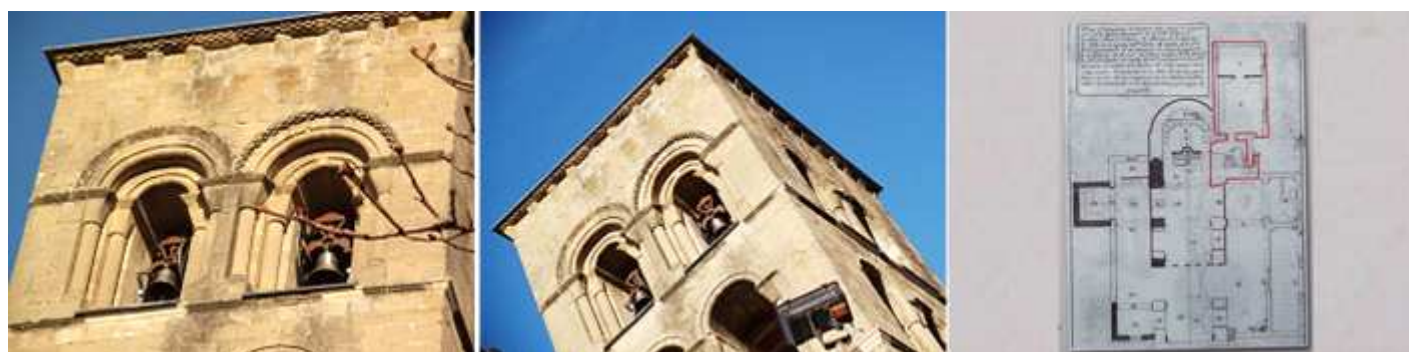
1 Último cuerpo del campanario. 2 Primeros planos de los vanos geminados. 3 Plano de la antigua colegiata, marcado en rojo la torre y la sacristía y el resto del desaparecido templo, tomado del cartel informativo de la Diputación de Huesca.
