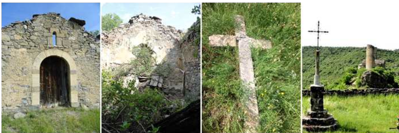
❶ Portada de la capilla con una puerta de medio punto de las mismas características que la de la entrada y con una ventana sobre su clave. ❷ El interior con su cubierta hundida. ❸ Lápida con una cruz de una persona llamada Teresa que falleció en 1899. ❹ Al fondo la torre y la iglesia.
