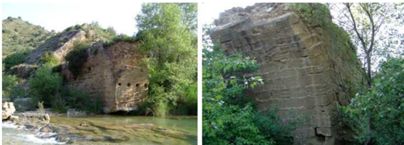
1 Completamente arruinado, en esta parte se aprecian los huecos de los mechinales para su construcción. 2 Imagen de la arcada opuesta. Fotos: José M. Seral.
