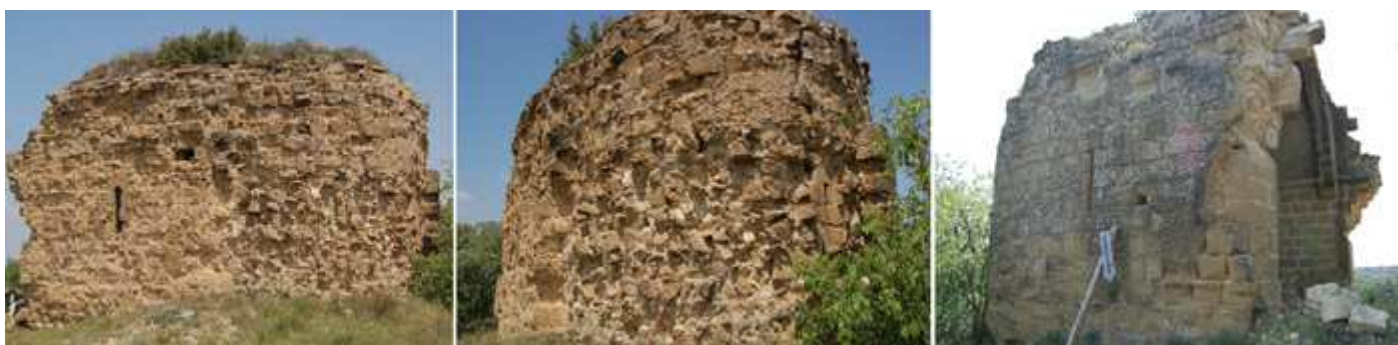
❶ Exterior de la ermita muro meridional del presbiterio con una estrecha ventana. ❷ Su parte exterior del ábside orientado al este igualmente con sus sillares degradados y desprendidos. ❸ Interior ❹ Lateral exterior del Evangelio donde la hembra ha conservado mejor la fachada, en este lado. Fotos: Silvia Arilla / Archivo Fotográfico Hoya de Huesca (SIPCA – www.sipca.es )
