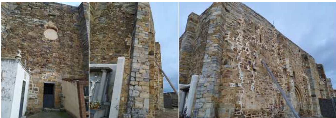
❶ Puerta existente adintelada en el hastial del templo y que da al cementerio sobre la misma los restos de óculo. ❷ Ángulo derecho de los pies del templo con una construcción funeraria adosada. ❸ En esta parte epistolar conserva algunas ventanas de aspillera. Fotos: Carlos Escribano.
