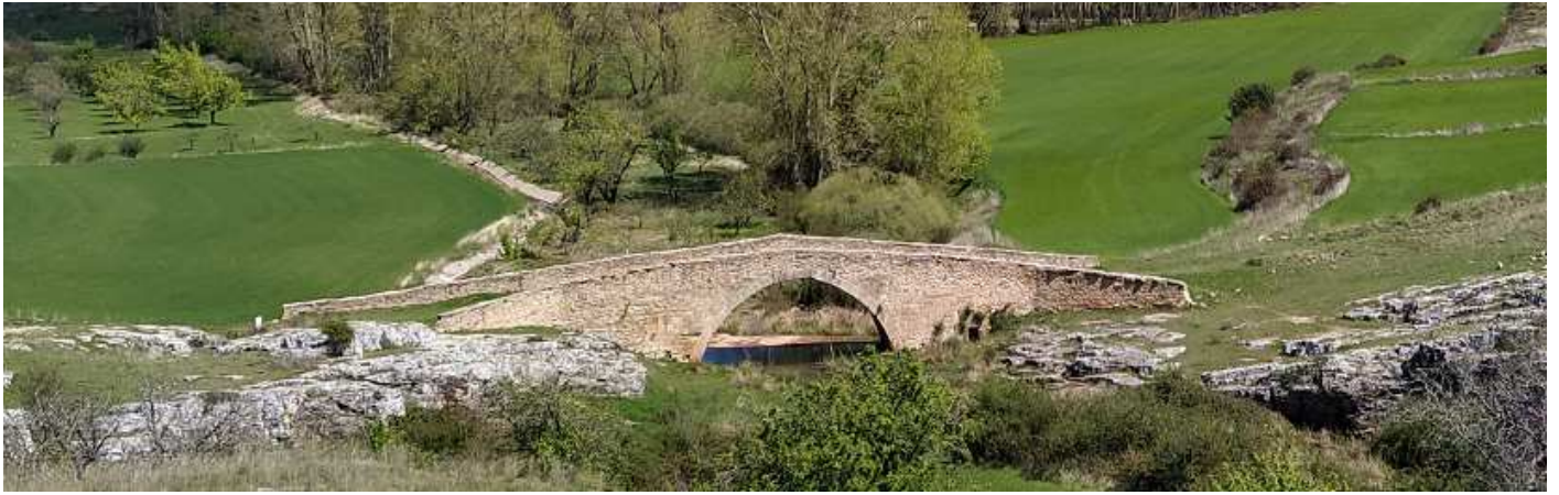
❶ Puente sobre el río Caracena de un solo ojo con ligero "lomo de asno" Se asienta en sus laterales sobre roca viva. Fotos: Diego Pacheco Landero.
