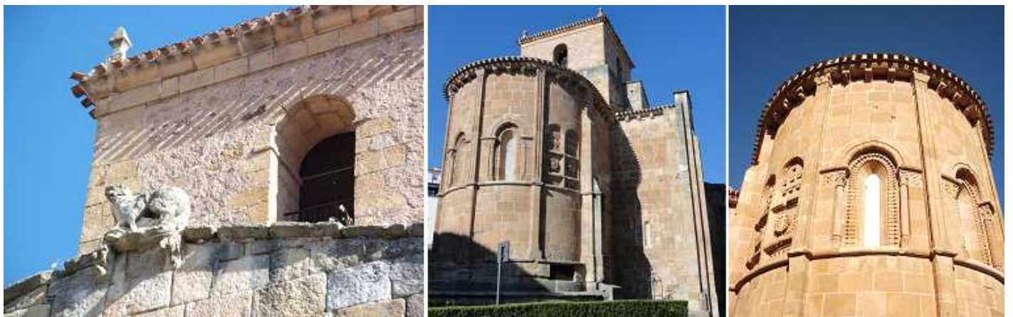
❶ Parte superior del crucero del Evangelio, un león sujetando su presa. ❷ Ábside con tres pilastras adosadas y dos contrafuertes. ❸ Con los dos paños centrales abiertos con ventanas con baquetones, y en los dos paños laterales también con ventanas ciegas decoradas, en la parte superior con siete flores.
