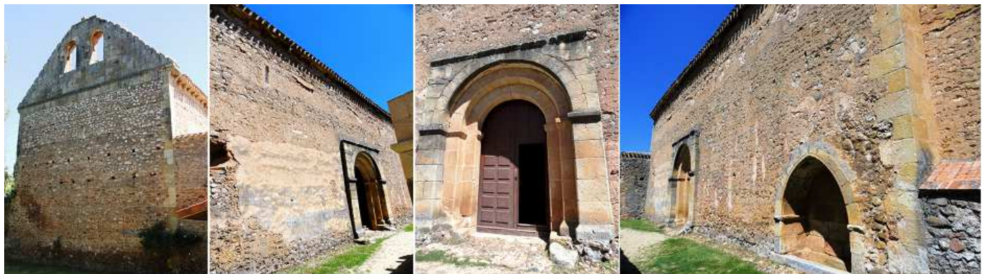
❶ Hastial culminado con un espadaña de dos vanos. ❷ Lateral con la portada adelantada. ❸ Puerta de tres arquivoltas lisas. ❹ En el lado de la portada, hay un arcosolio.
