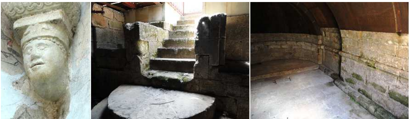
❶ Ménsula con una cara humana en el arranque de la bóveda donde están las pinturas. ❷ Escaleras de bajada a la cripta. ❸ Lateral de lado derecho, y una imposta corrida redondeada recorre toda la cripta.
