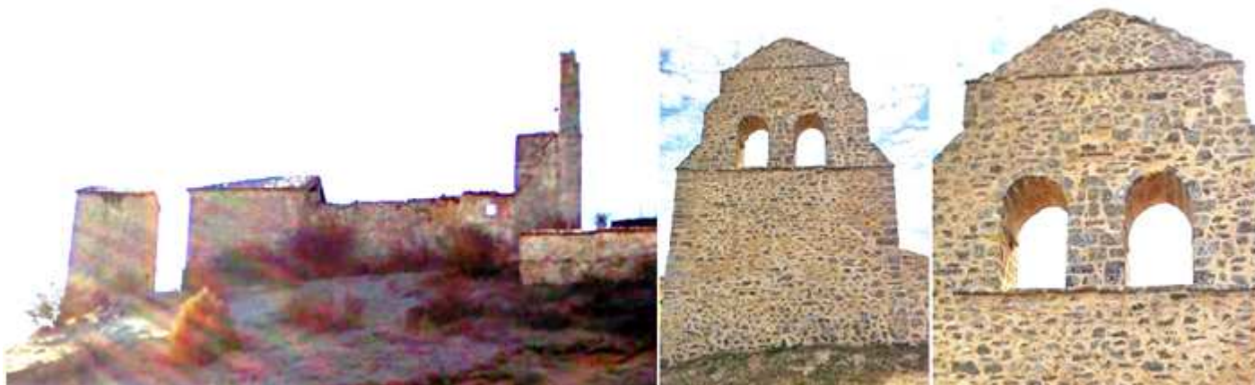
① Sus ruinas consolidadas sobre la parte alta de esta loma que divide toda la vega. ② Lo más destacable su sólida y alta espadaña de mampostería. ③ La parte superior con dos finas impostas enmarcan los vanos de donde tuvo sus campanas Fotos Sergio Fernández Barranco.
