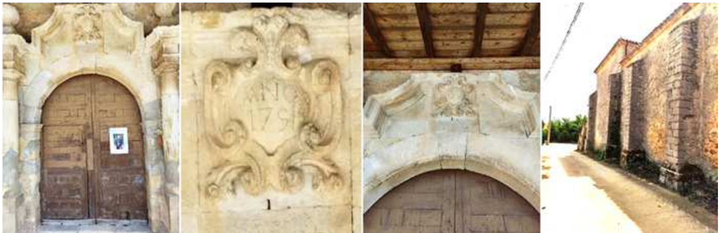
1 Detalle de la puerta del templo con su arco de dovelas lisas. 2 En la parte superior del arco un escudo decorativo con la fecha de 1751, de la posible reforma de esta parte. 3 Parte superior del arco de su puerta. 4 Lateral exterior del Evangelio con sendos contrafuertes. Fotos Sergio Fernández Barranco
