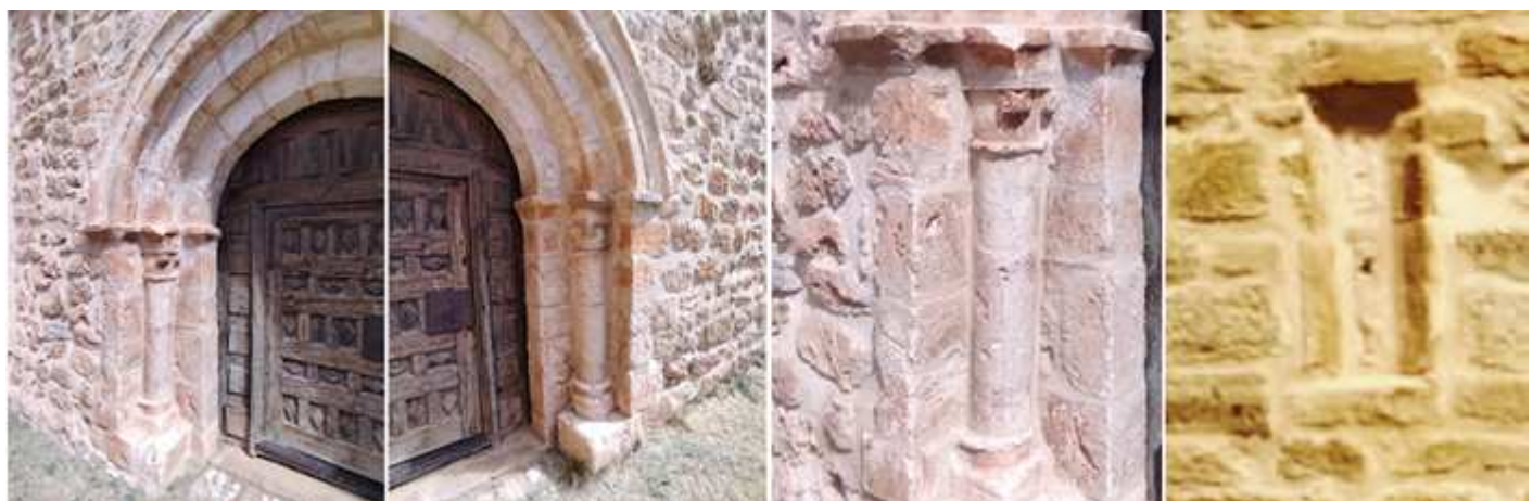
❶ La parte izquierda de su puerta que cuenta con una columna acodillada. ❷ Y con las mismas características el lado derecho. ❸ Con un capitel con hojas vegetales recogidas en volutas. ❹ Detalle de la ventana adintelada en el ábside. Fotos Sergio Fernández Barranco
