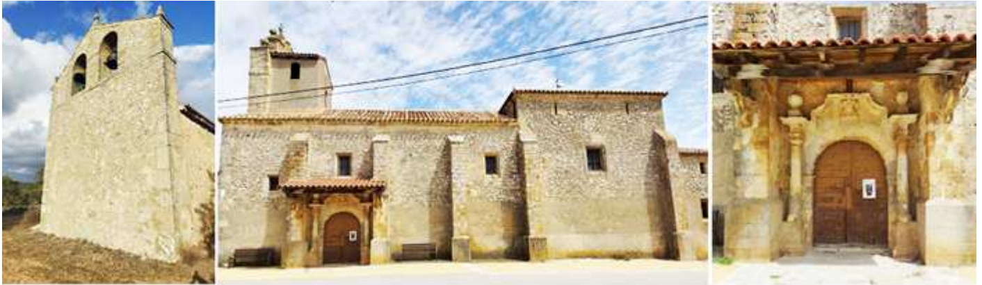
1 Su espadaña abierta con dos vanos de medio punto donde aloja sus campanas. 2 Fachada meridional con diversos contrafuertes y algo más alto el tramo del crucero. 3 m. Fotos Sergio Fernández Barranco.
