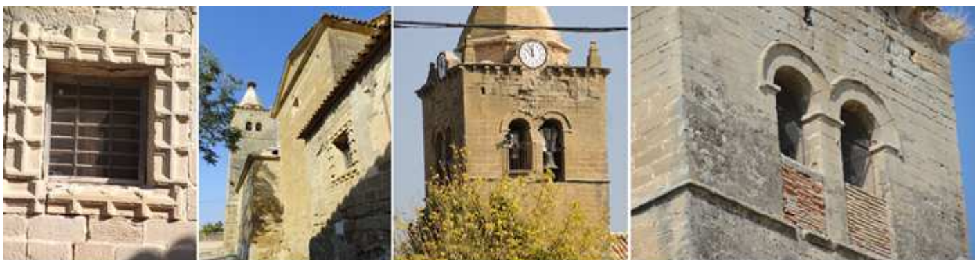
❶ Esta sacristía posee esta ventana que dispone de este marco en piedra. ❷ El lado epistolar con la torre al fondo. ❸ Los relojes entre el alero de su torre y el tambor del chapitel piramidal. ❹ Detalle de estas dos ventanas cegadas en parte.
