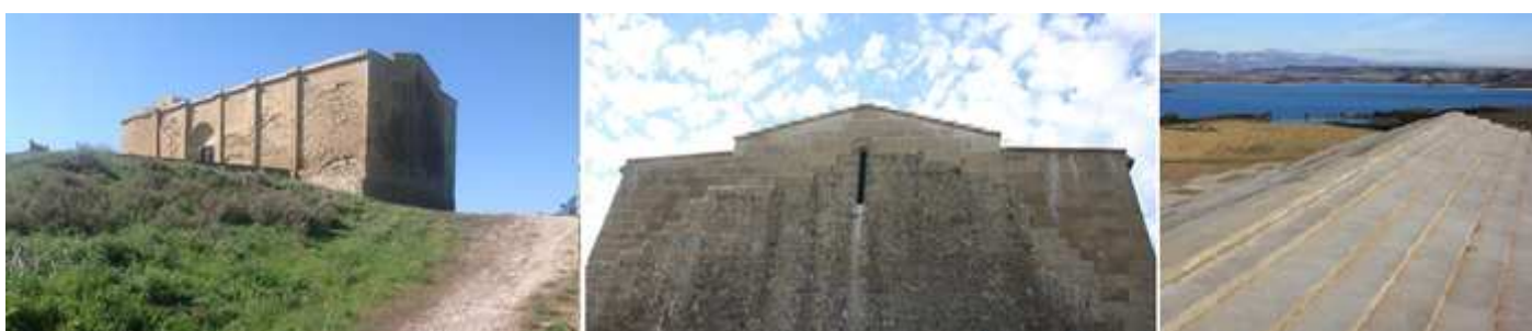
① Fachada sur, el edificio está construido con piedra sillar caliza. ② Ábside con una ventana de aspillera. Y una cubierta a dos aguas. ③ La nueva cubierta de losas de piedra. Fotos http://www.alazets.com
